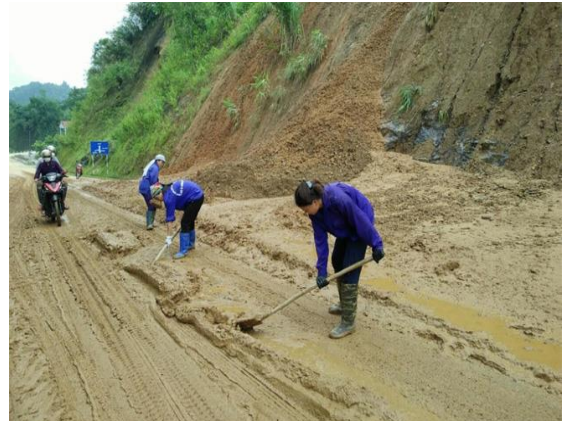
Đường tỉnh lộ 258 xã Chu Hương, huyện Ba Bể bị sạt lở do lũ quét (12-6-2019)
