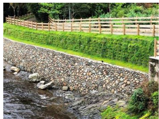
Hình 2. Tường chắn lũ
