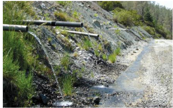
Hình 54. Hệ thống ống thoát nước trên mái dốc
