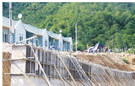
Hình 19. Bản Na Sá, xã Na Mèo được xây dựng tại vị trí an toàn với hệ thống tường bao kiên cố chống sạt lở
